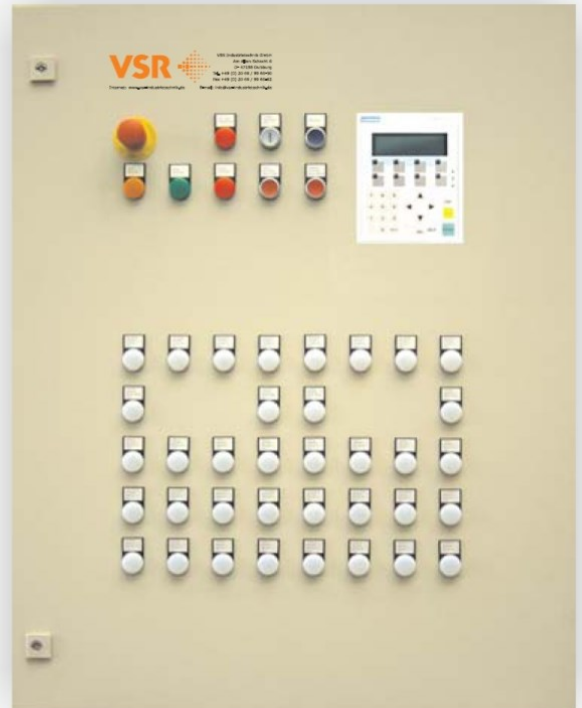
Elektrisk S7 Betjeningsskab for styring af flere Luftkanoner
