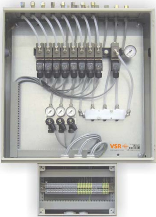
Kabinet med magnetventiler for styring
